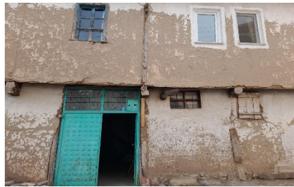
Fotoğraf 5: Geleneksel Meskenlerde Değiştirilen Kapı ve Pencere
